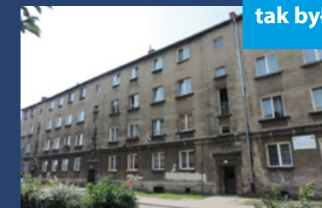
Stare nieestetyczne elewacje
